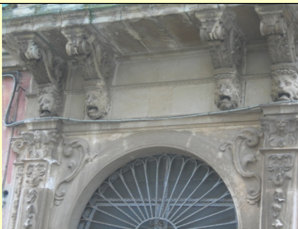
FOTO 2 – Particolare dei "gattoni" del balcone sovrastante l'ingresso principale
